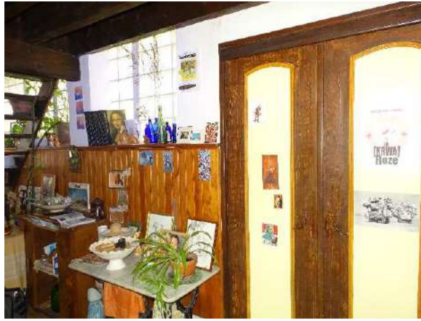
La jouée de gauche du claustra comporte des traces de moisissures.
