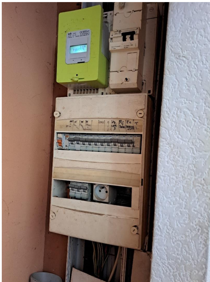
Compteurs situés dans le placard
